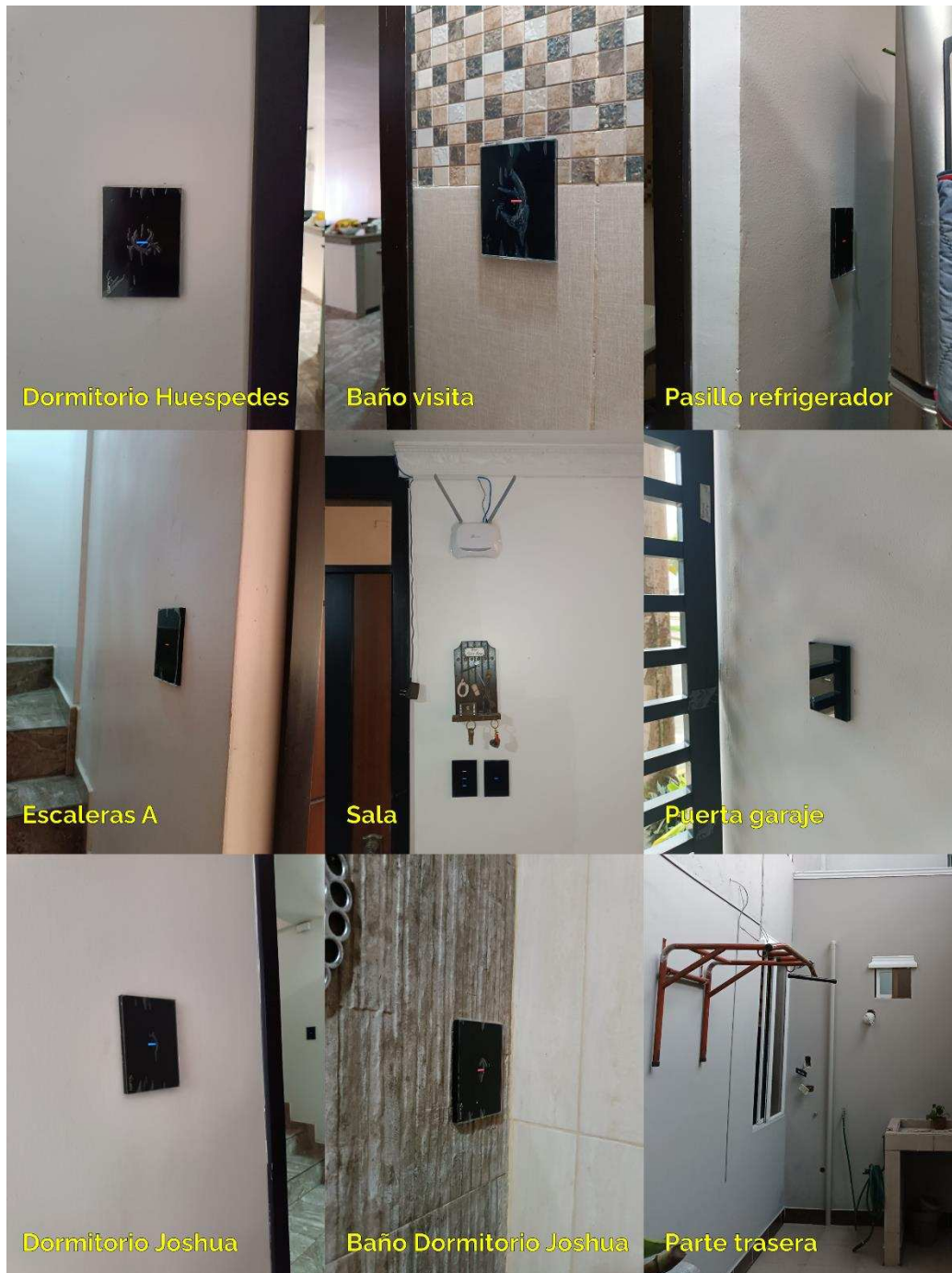
Fig. 23. Interruptores inteligentes instalados en la plana baja
