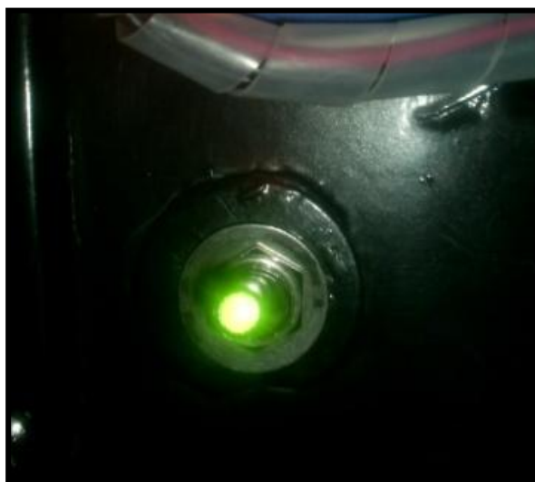
Figura 5.17: Master switch del sistema
