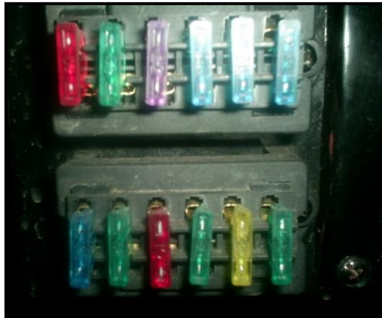
Figura 5.3: Fusibleras y fusibles nuevos
