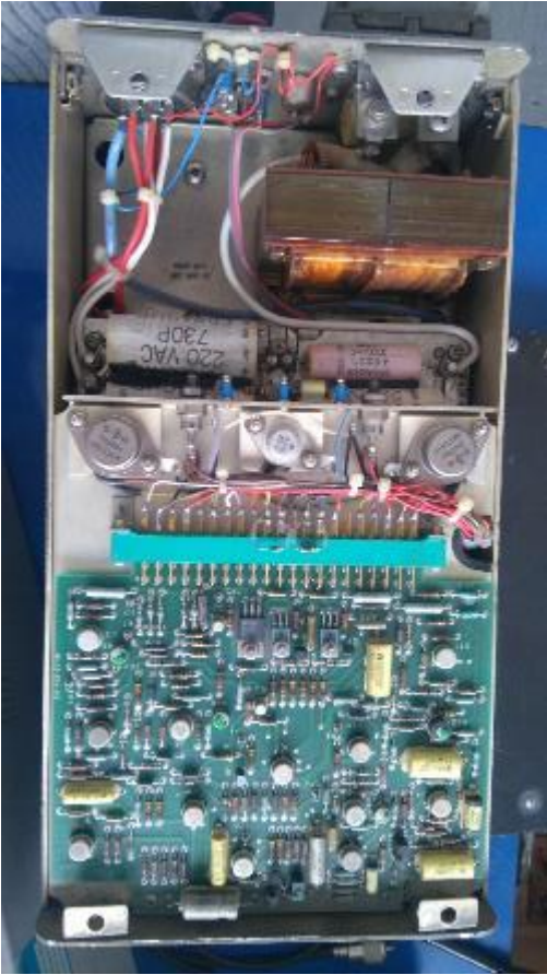
Inversor destapado para verificación
