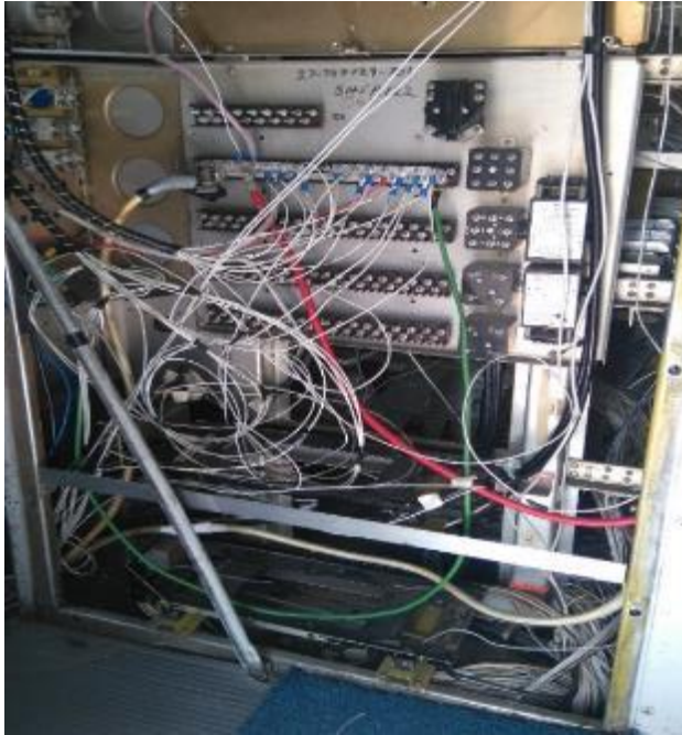
Revisión panel eléctrico derecho
