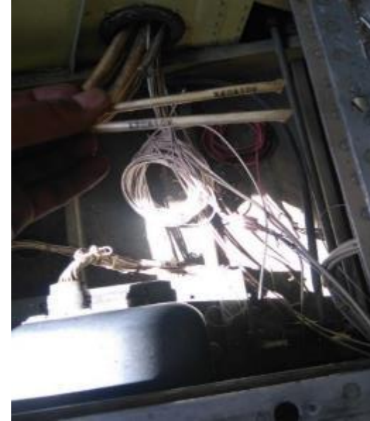
Revisión panel eléctrico inferior
