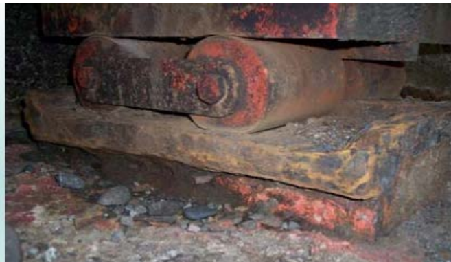
Figura 2-16 Apoyos con Oxidación (Ing. Jáuregui 2007)
