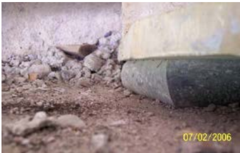
Figura 2-20 Neoprenos con deformación (Ing. Jáuregui 2007)
