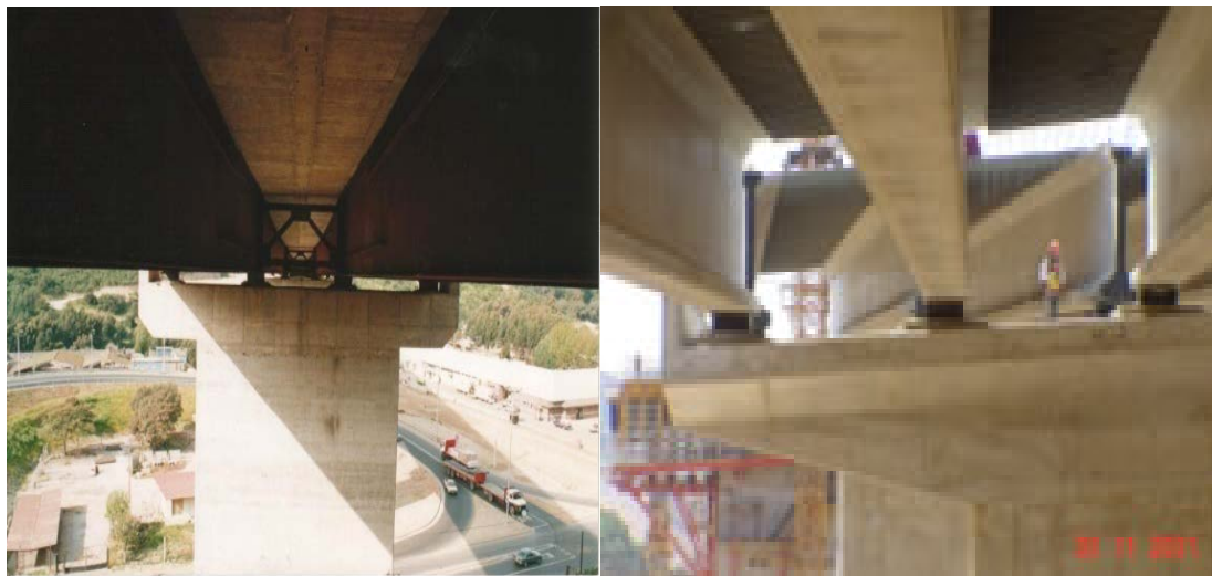
Figura 2-42 Localización de Aisladores Sísmicos - Viaducto Marga-Marga
