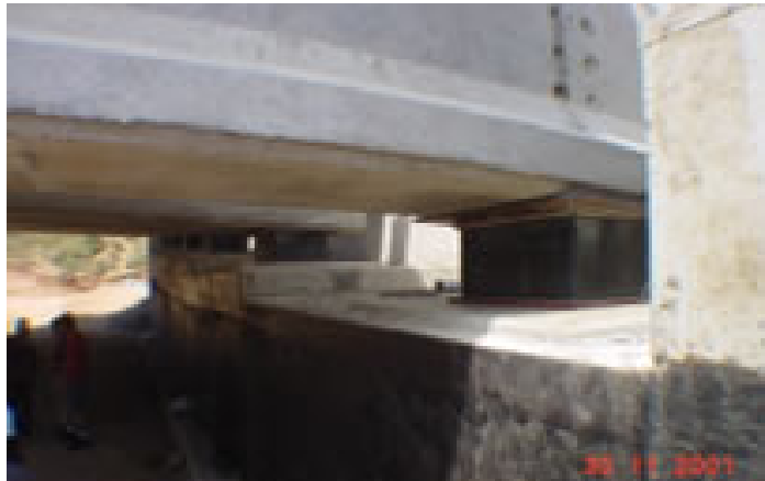
Figura 2-43 Aislador instalado en el puente Marga Marga
