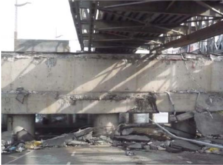
Figura 1-5 Caída del Tablero por falta de apoyo (Dr. Aguiar 2010)
