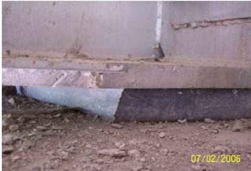
Figura 2-19 Neoprenos con deformación (Ing. Jáuregui 2007)
