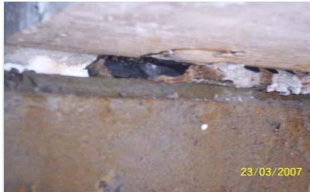
Figura 2-15 Neopreno con degradación (Ing. Jáuregui 2007)
