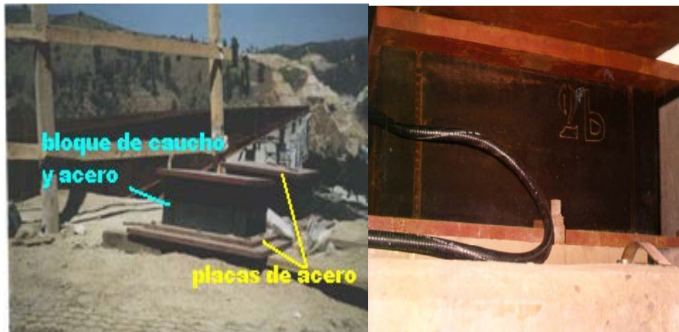
Figura 2-39 Aisladores usados en el Puente Marga-Marga
