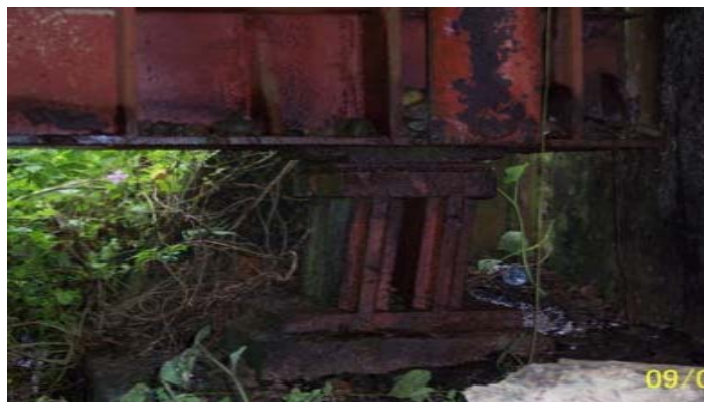
Figura 2-17 Apoyos con Oxidación (Ing. Jáuregui 2007)
