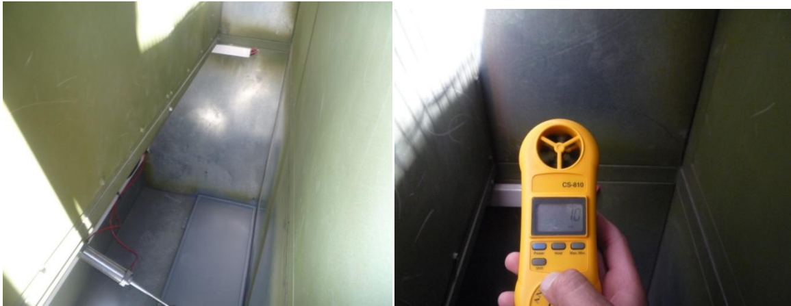
Figura 6.8. Conducto de entrada y su medición.
