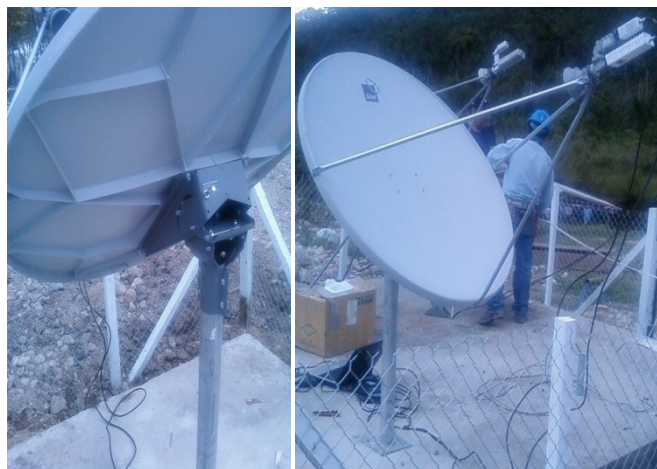
Figura 3.14 Antena de transmisión y recepción de 1.20 m en banda Ku GILAT
