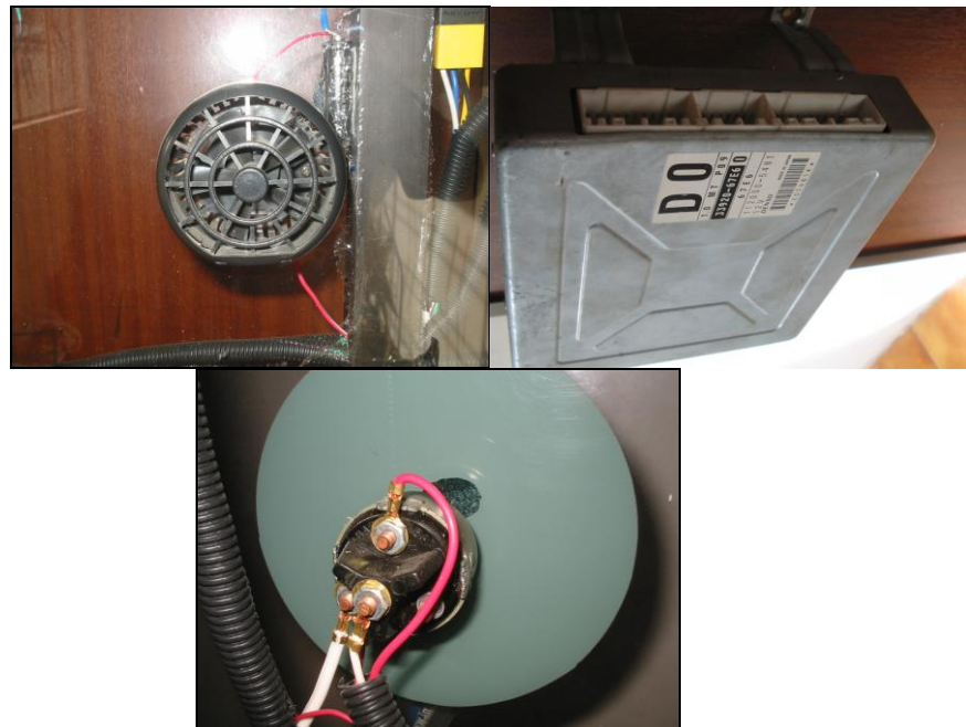
Figura 5.14 . Instalación de ECU, ventilador y Switch.
