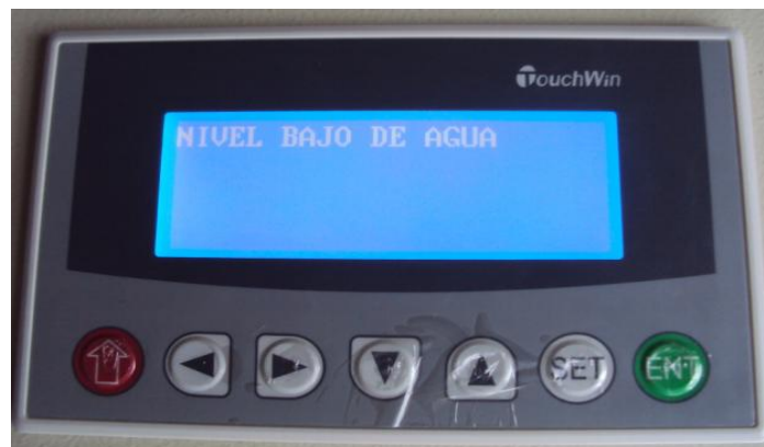
Figura 87: Alarma de nivel bajo de agua
