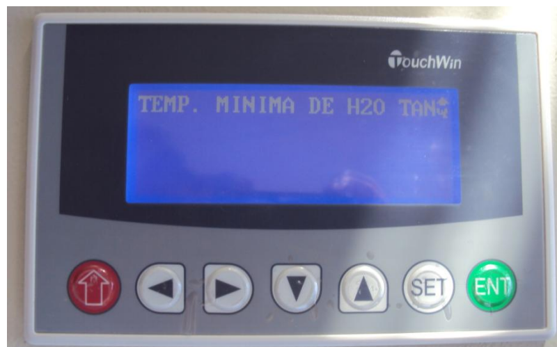
Figura 82: Alarma de temperatura baja
