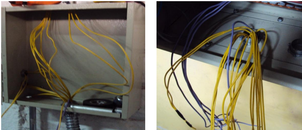
Figura 71: Cableado de la planta hacia el tablero
