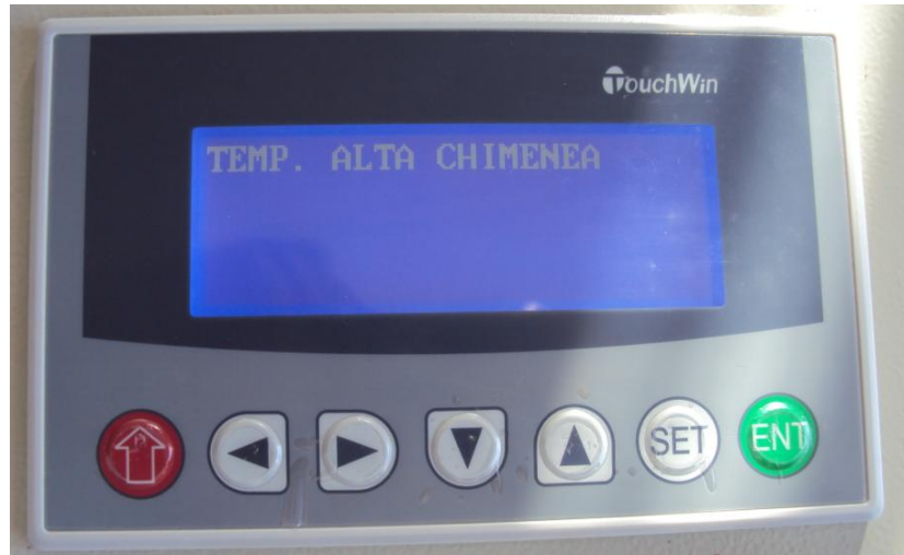
Figura 81: Alarma de temperatura alta
