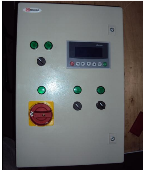
Figura 33: Tablero de control
