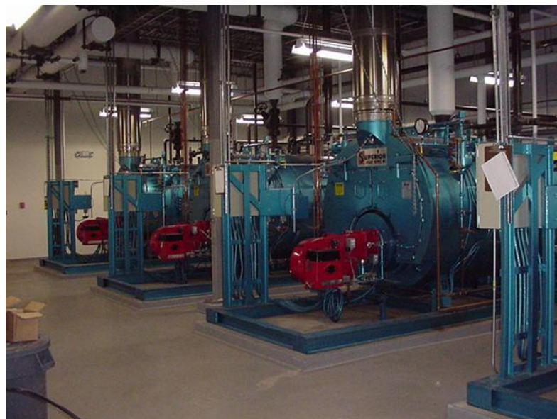
Figura 17: Calderas de vapor
