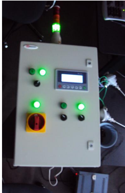
Figura 34: Alarmas en el tablero
