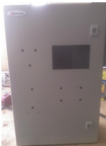
Figura 62: Tablero de mando cortado
