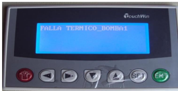
Figura 83: Alarma falla del térmico de la bomba1
