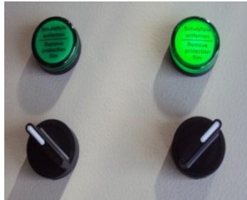
Figura 13: funcionamiento de bomba 2 modo automático
