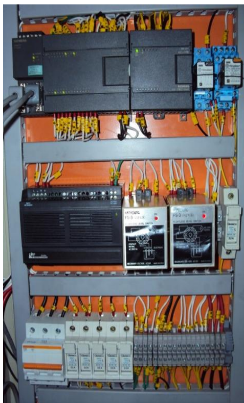
Figura 61: Distribución de elementos en el tablero de mando
