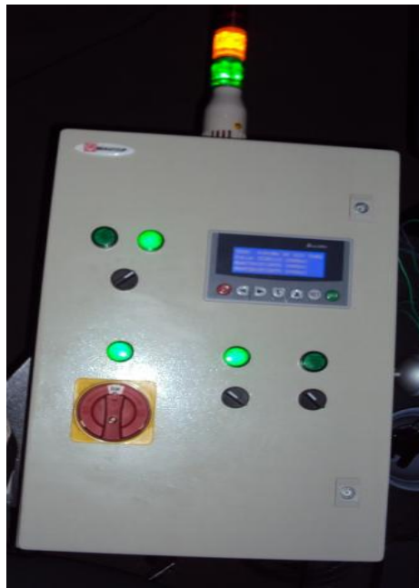
Figura 76: Tablero en forma manual
