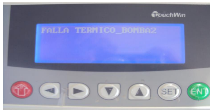
Figura 84: Alarma de falla de térmico de la bomba 2
