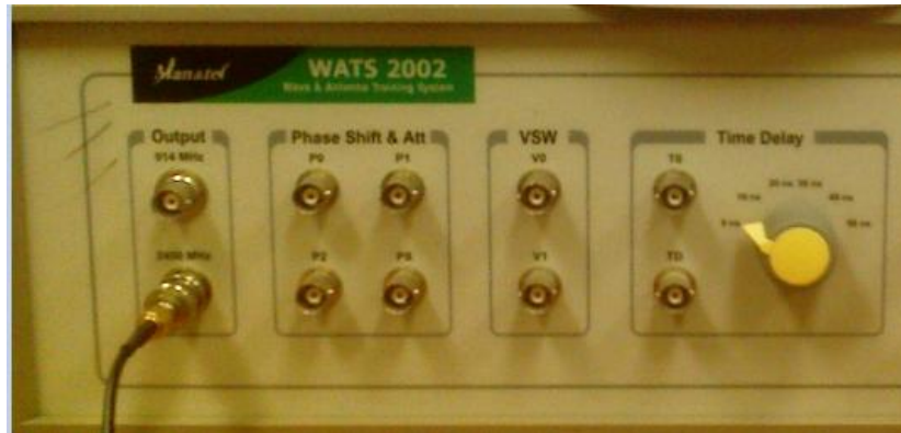
Figura 52. Conexión de cables con su conector de las antenas en los terminales de salida de señal RF.
