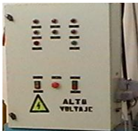
Figura 1.8 Panel de Control de la fuente Hidráulica
