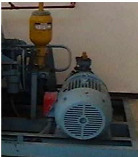
Figura 1.11 Sistema de Bomba hidráulica derecha
