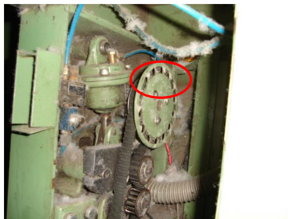
Figura 2.2 Ubicación de sensor de proximidad en la Carda C4
