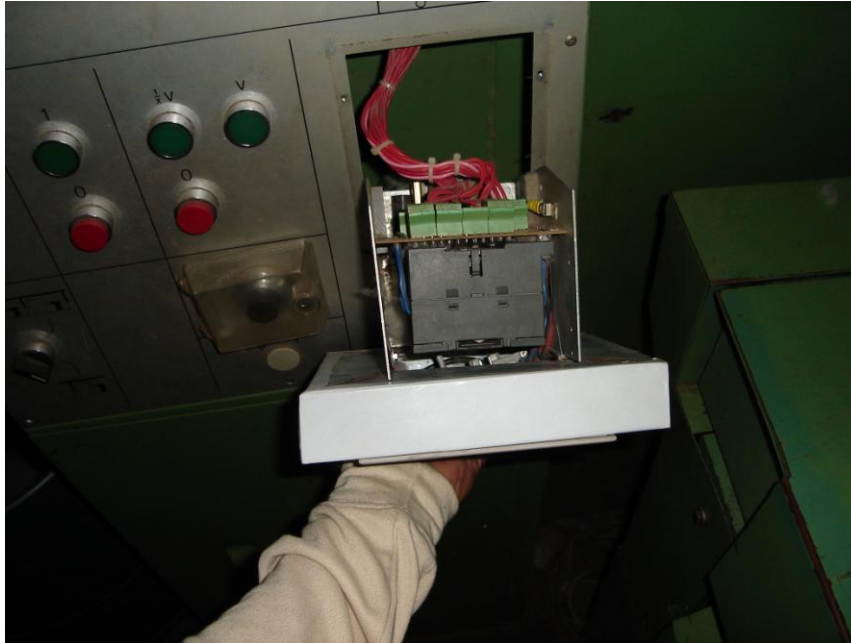
Figura 3.23. Contador finalizado e instalado en la maquina.
