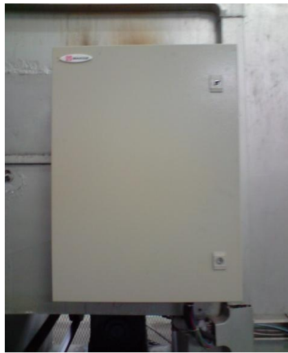
Figura 4.27 Gabinete metálico para el variador
