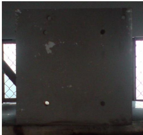
Figura 4.5 Placa Base del Moto reductor
