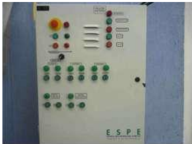
Figura 3.3 Tablero de control.
