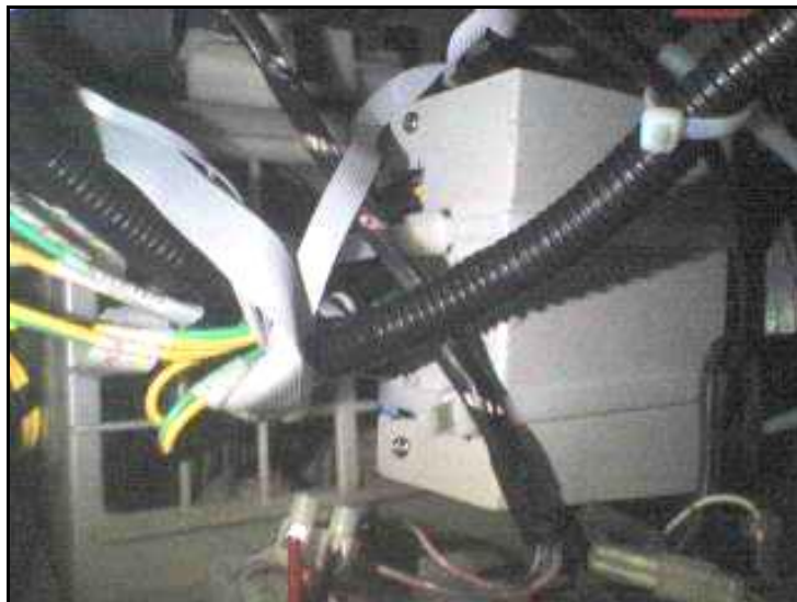
Figura 3.71 Montaje final del modulo de control y potencia.
