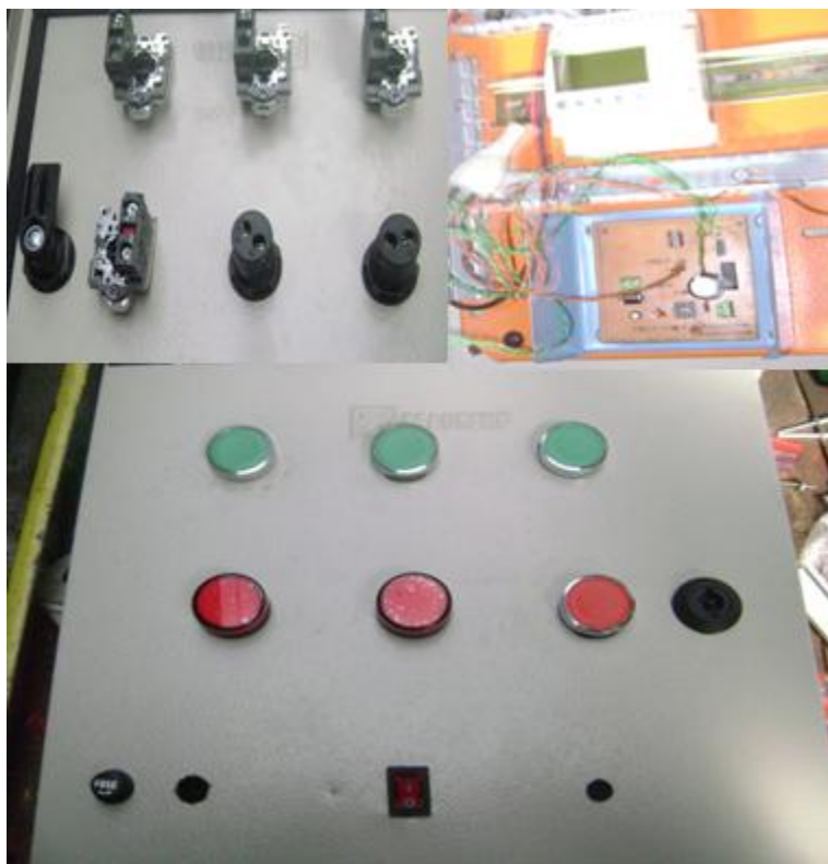
Figura 3.14. Colocación de los elementos de control.
