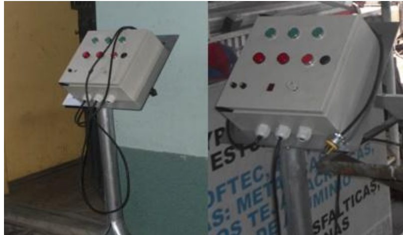
Figura 3.15. Tablero de control listo y empotrado al trípode
