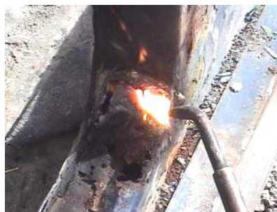
Gráfico 49 (Corte parcial de la sección dañada del montante)
