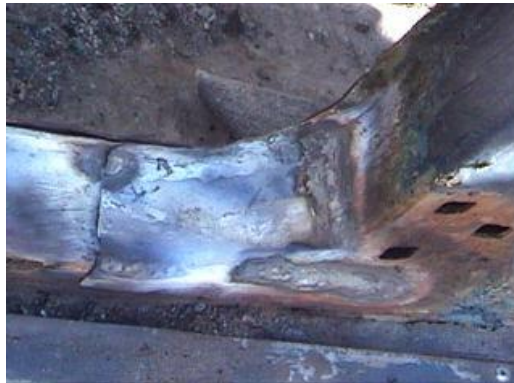
Gráfico 50 (Pieza reemplazada de la sección dañada del montante)
