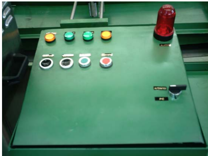
Figura 3.12 Tableros de control y maniobra.
