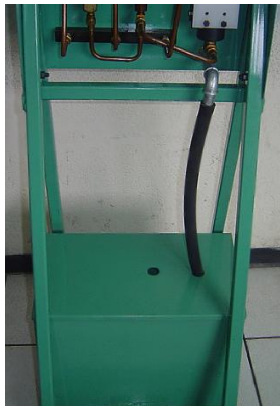
Fig. 6.7 Llaves de paso para la entrada de
