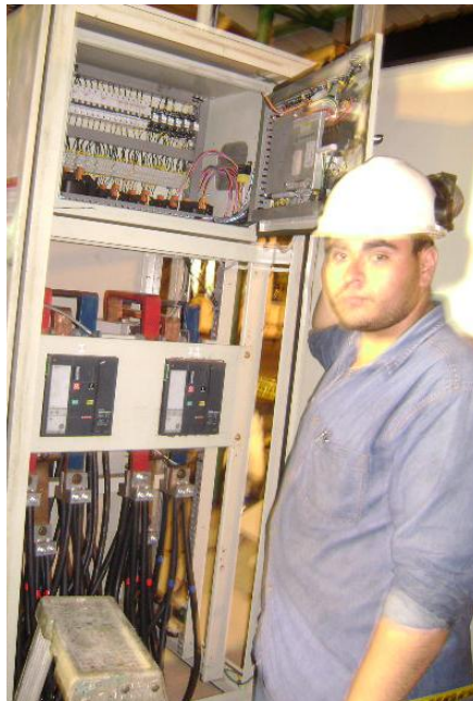
Figura Nº 3.1 Tablero de transferencia automática de Energía
