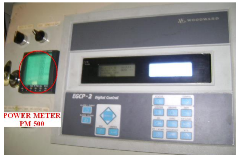
Figura Nº 4.5 Medidor de Energía PM 500
