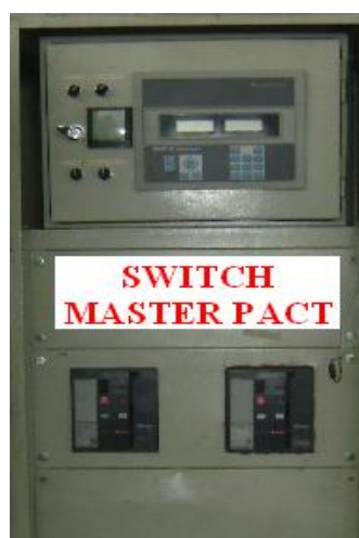
Figura N° 4.4 Swich de potencia del Tablero de Transferencia de Energía
