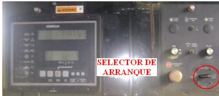
Figura N° 4.3 Selector de Arranque del Panel de Control
