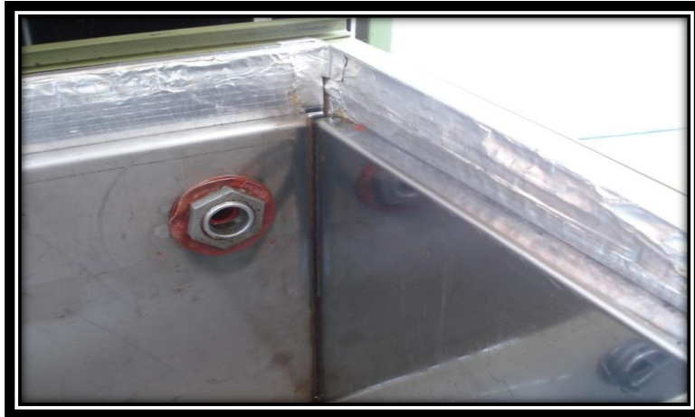
Figura 2.62 Tanque de almacenamiento de aceite
