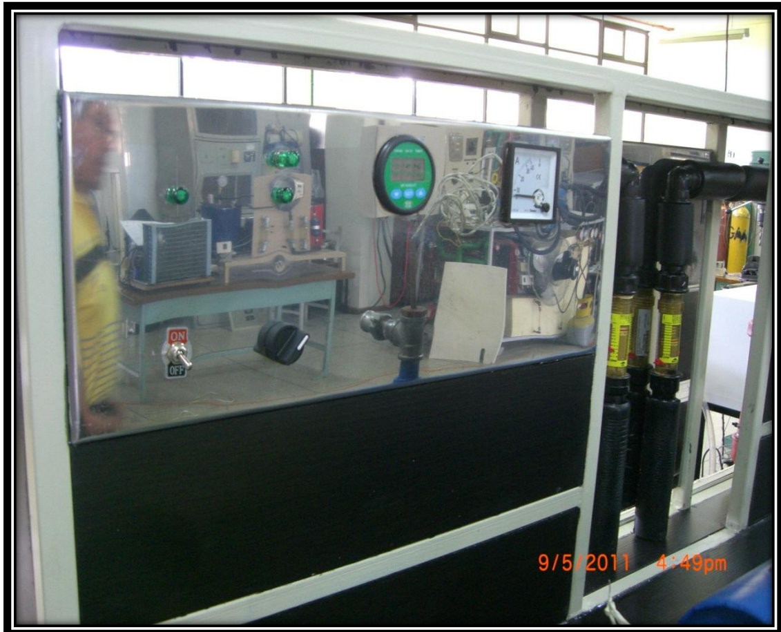
Figura 5.11 Panel de control de instrumentos para medición del banco de pruebas.
