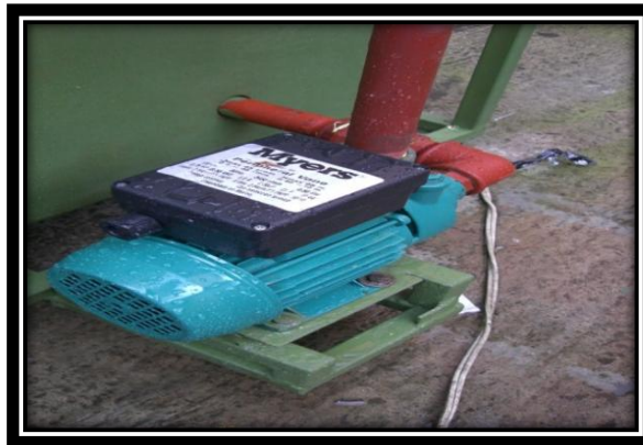
Figura 2.64 Bomba utilizada para transportar el aceite
