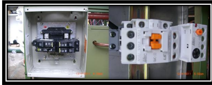
Figura 6.7 Breaker y contador
