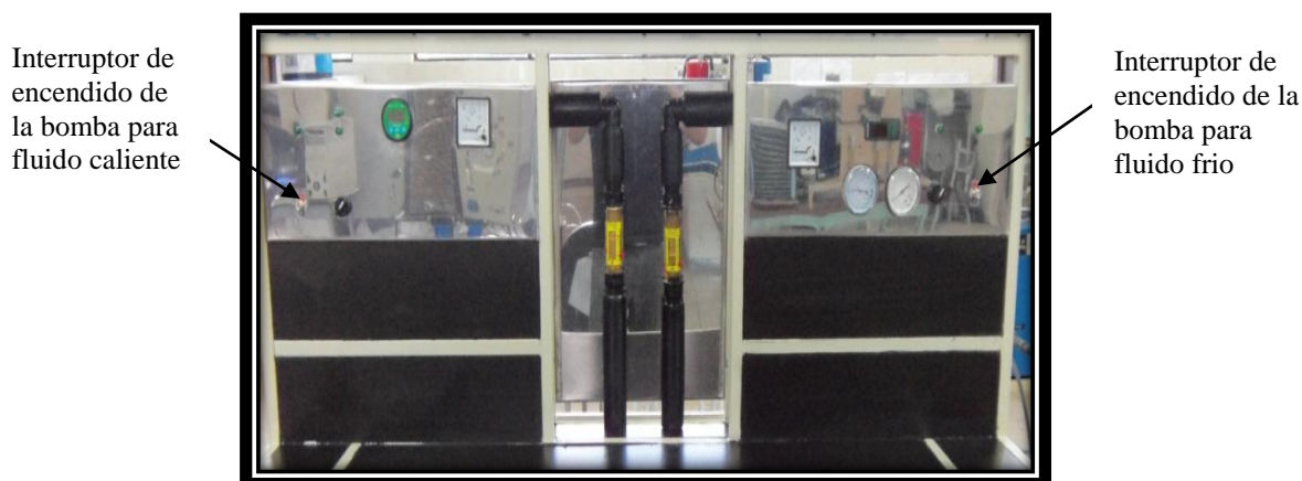
Figura K.11 Encendido de las Bombas
