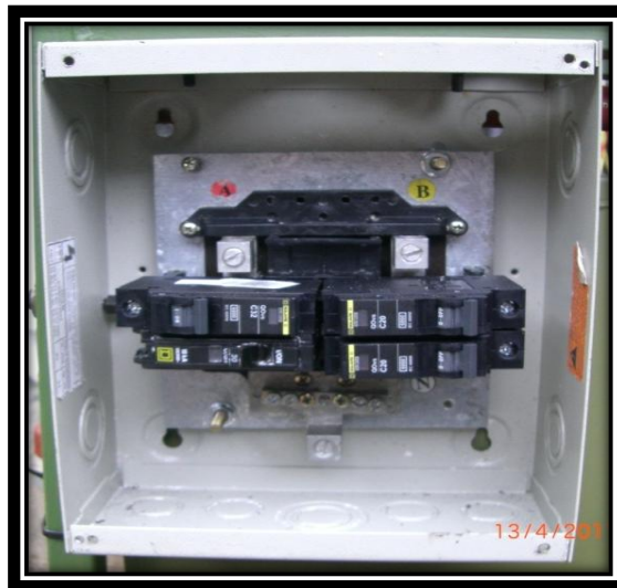
Figura 2.71 Caja de breaker
