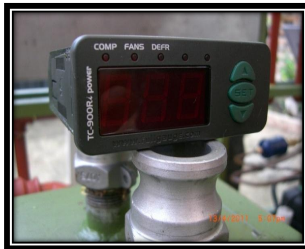
Figura 2.68 Control digital de temperatura para agua
