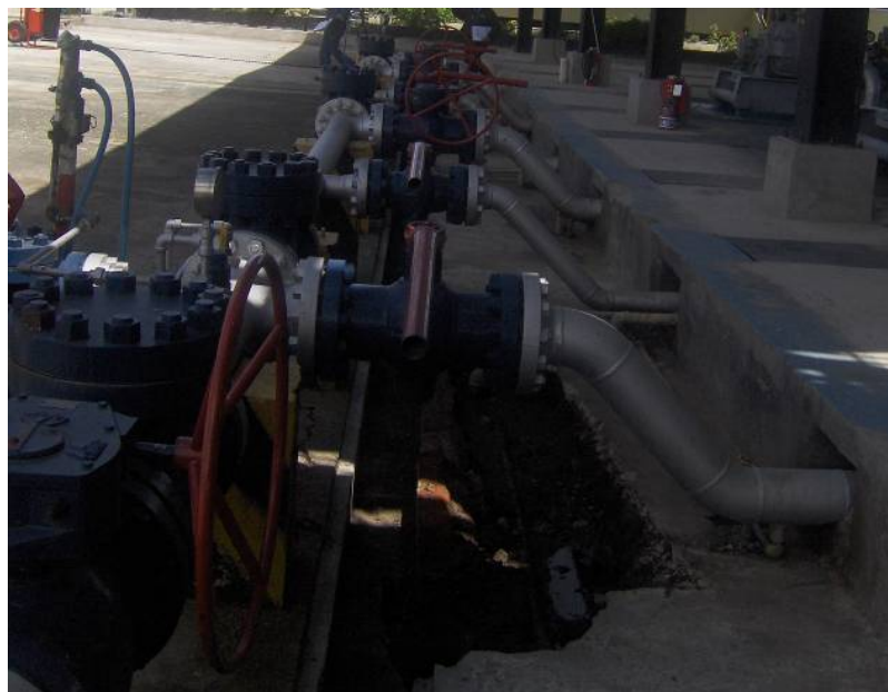
Figura 2.4. Manifold Secundario de Salida.
