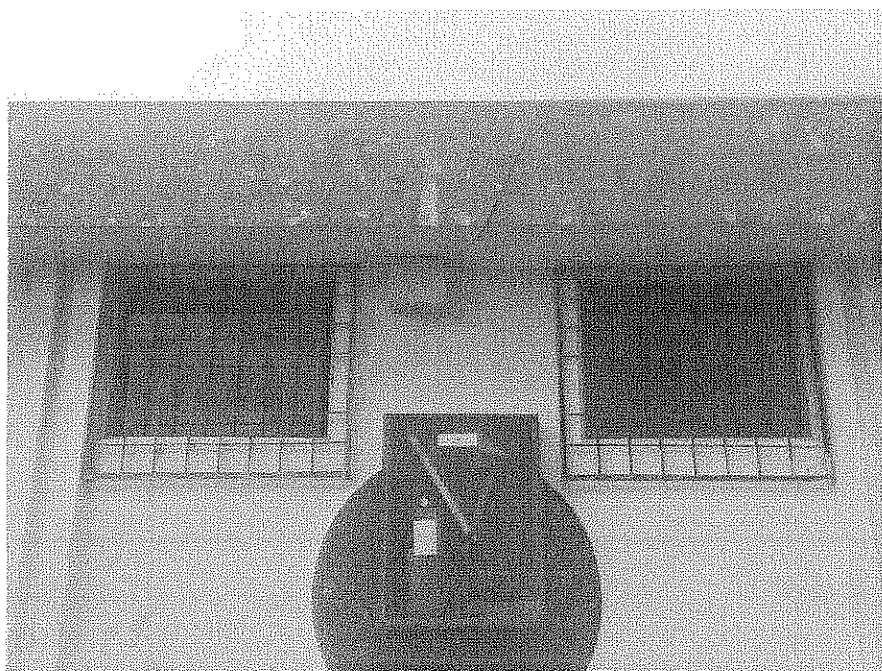
SIRENA DE ALARMA DE LA BODEGA DE MATERIAL BÉLICO
