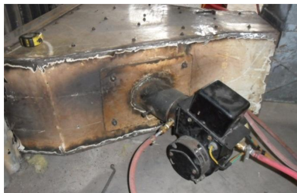
Figura 3.31: Montaje del Quemador
