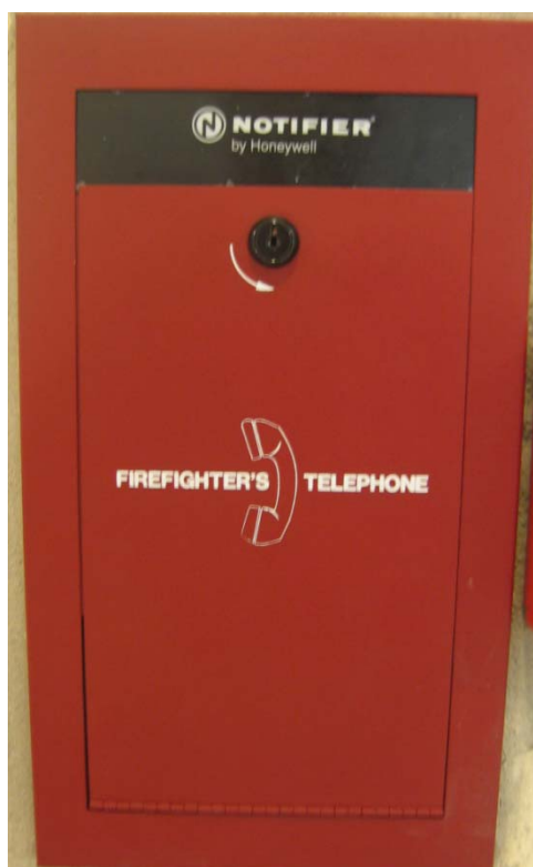
Figura 6.25.- Foto Teléfono de Incendios.
