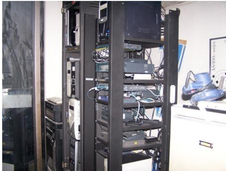
Figura 1.6 Cuarto de equipos
