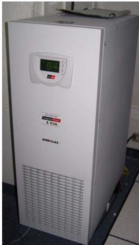
Figura 3.4 UPS ANDOLA 8KVA
