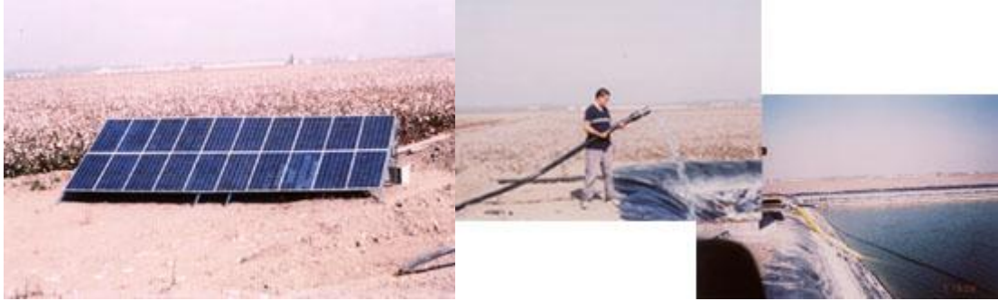
Figura 2.22 Sistema de Bombeo de Agua
