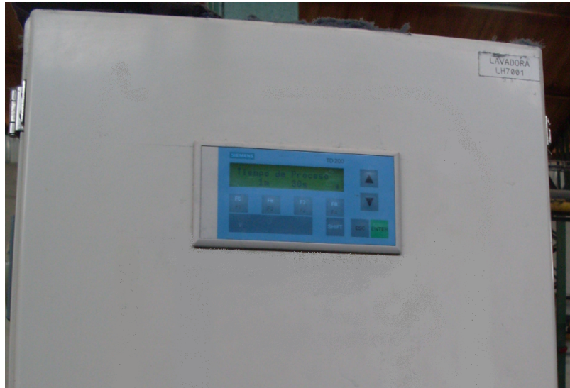
Figura. 3.11. Tablero de Control modo local, localización de TD-200
