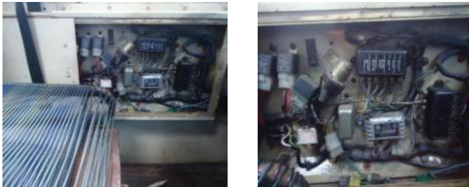
Gráfico No 37: Caja de relés–fusibles sulfatados y destruidos
