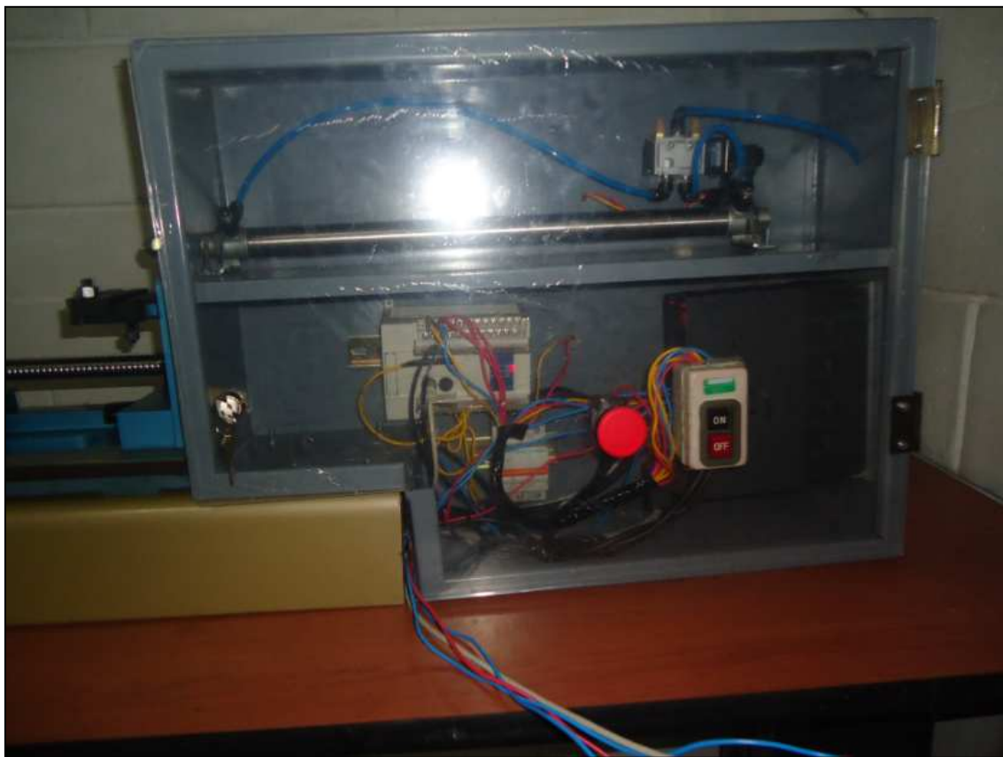
Figura 4.11. Gabinete de potencia eléctrica y control. 130
