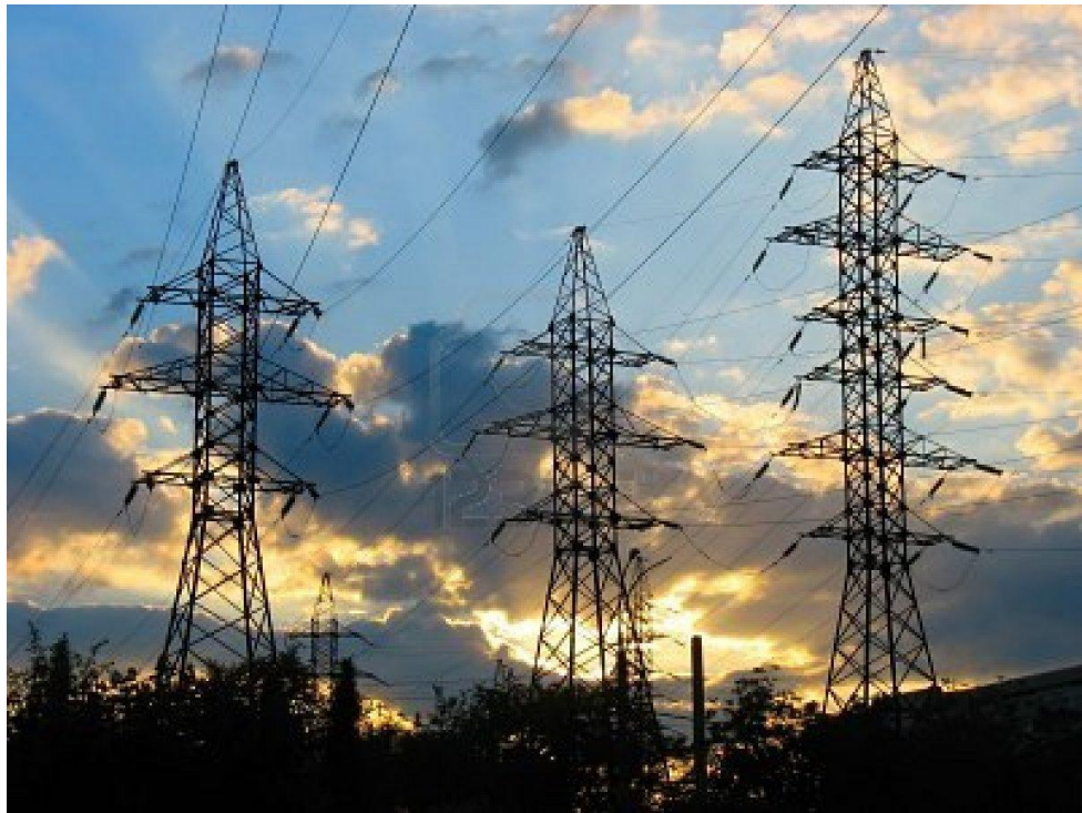
Figura 2-3 Torres de transmisión de energía eléctrica
