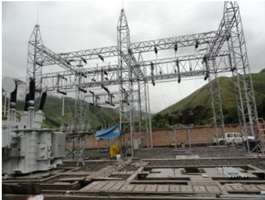
Figura 2-4 Estructura de línea de subtransmisión eléctrica
