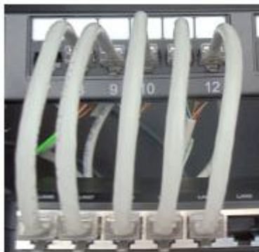
Figura 4-76 Conexión patch panel - switch
