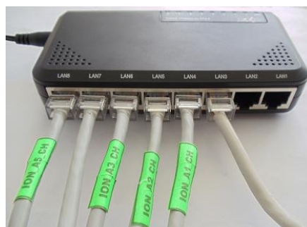
Figura 4-77 Conexión al switch
