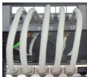
Figura 8-9 Conexión patch panel - switch
