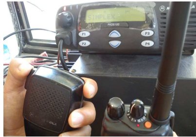
Figura. 3.64. Verificación de transmisión desde la radio base a la radio portátil
