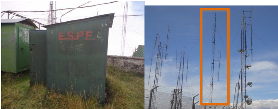
Figura. 3.1 Caseta y Antena de la Repetidora en Cruz Loma
