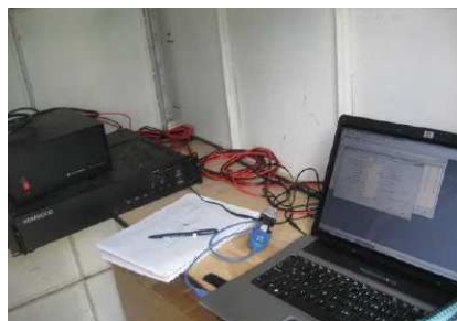
Figura. 3.44. Repetidora Kenwood TKR750 y Software Hardware de programación
