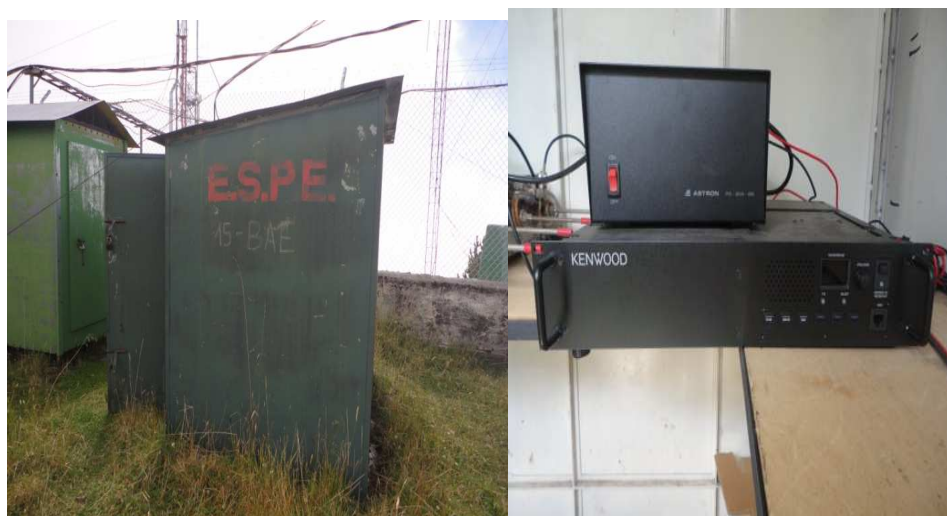
Figura. 2.6. Caseta y Equipo de la Estación Repetidora en Cruz Loma
