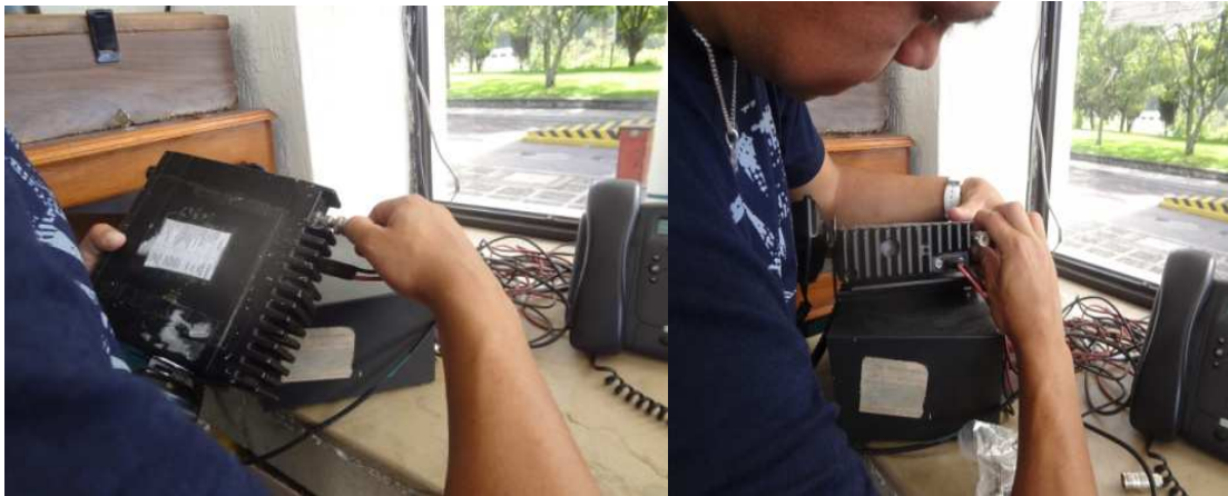
Figura. 3.10. Verificación de conexiones Radio Motorola GM-300 ESPE Matriz
