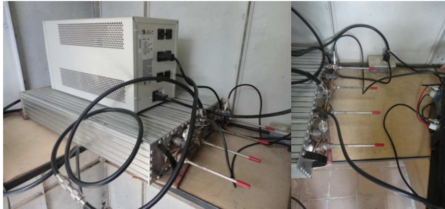
Figura. 3.3. Duplexor y Fuente (Repetidora)
