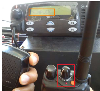
Figura. 3.62. Verificación del grupo SIMPLEX y del canal 2 asignado
