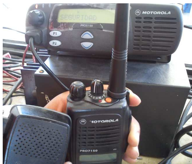
Figura. 3.61. Verificación de transmisión desde la radio base a la radio portátil
