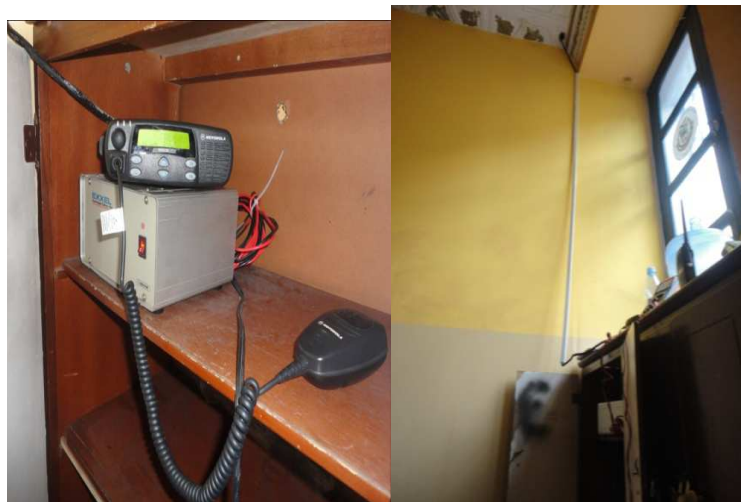
Figura. 3.13. Radio Base PRO 5100 Héroes del Cenepa y Entrada de la Bajada de Antena
