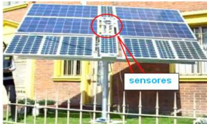
Figura 1.17: Seguidor solar automático con sensores sensibles a la luz solar
