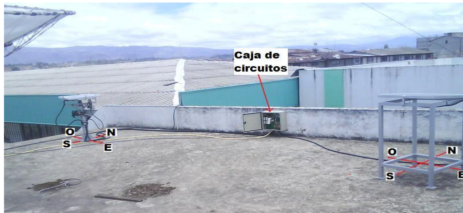
Figura 2. 28: Ubicación de la caja de circuitos.
