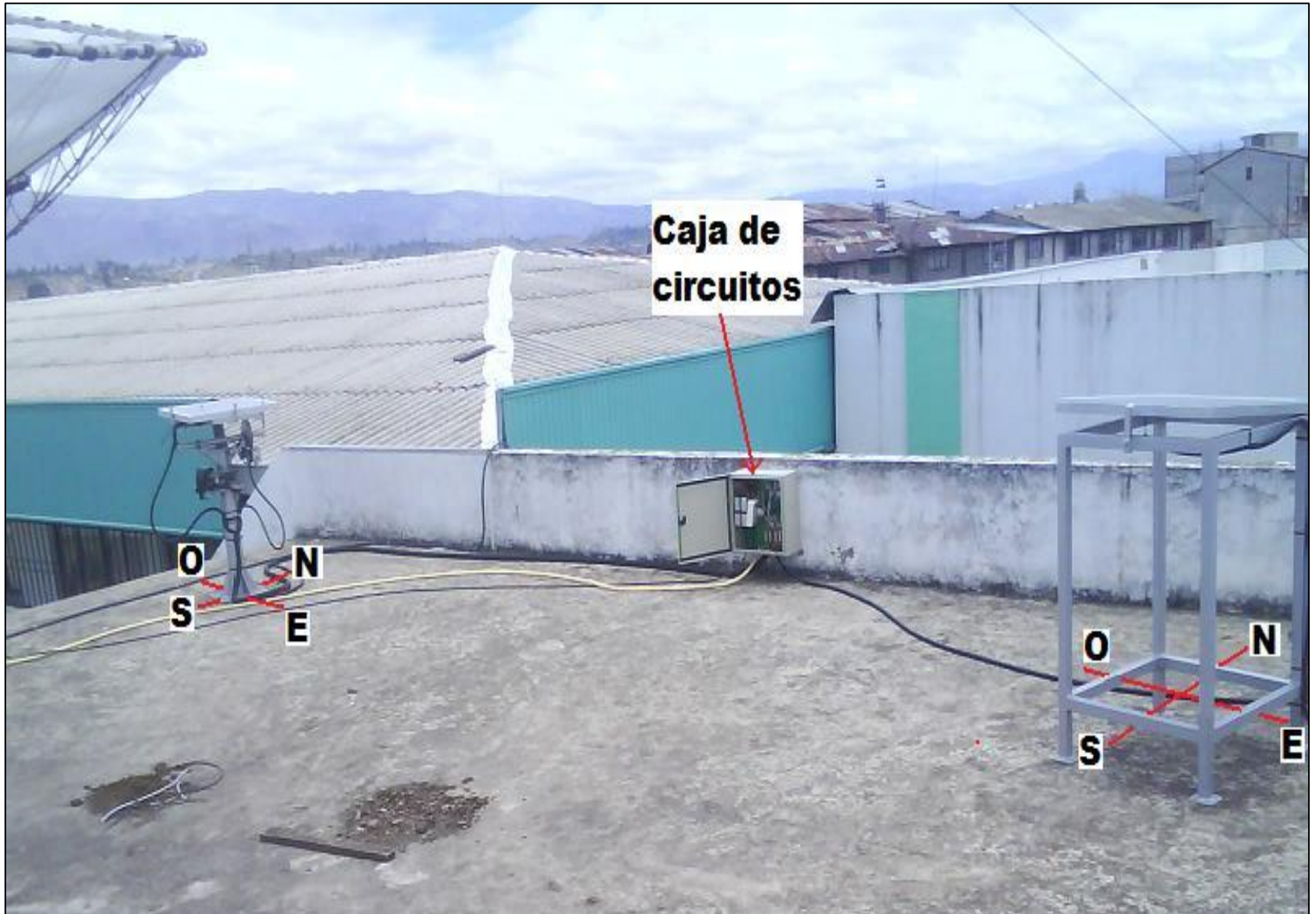
Ubicación de la caja de circuitos.
