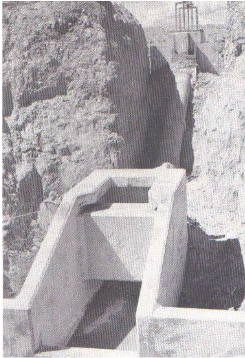
Fotografía 2.2: Caídas en tubo en canales de fuerte pendiente
