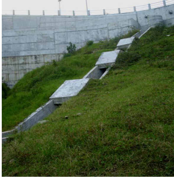
Fotografía 2.8: Canal de Rápidas con Tapa y Columpio (CRTC). Vista A.
