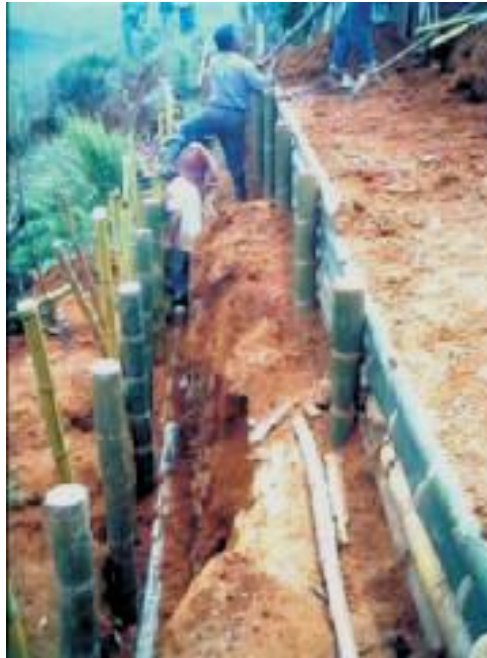
Fotografía 2.16: Disipadores de energía escalonados, usado en laderas. Vista A. Fuente. Instituto Nacional de Defensa Civil- Perú
