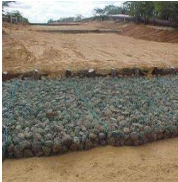
Fotografía 2.18: Colchonetas disipadoras de energía.
