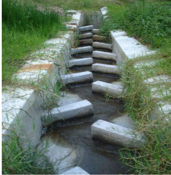
Fotografía 2.7: Canal de Pantallas Deflectoras.
