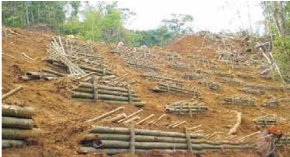
Fotografía 2.17: Disipadores de energía usados en laderas. Vista B Fuente. Instituto Nacional de Defensa Civil- Perú.
