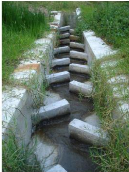
Fotografía 3.1: Canal de Pantallas Deflectoras.
