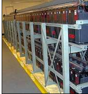
Figura 1.19: Banco de baterías [0]
