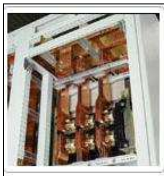
Figura 1.13: Tablero de alimentación [I]
