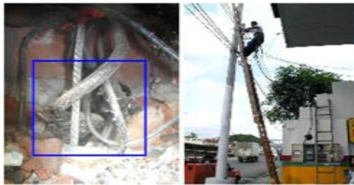
Figura 1.2 derivaciones ocultas, se puede apreciar los conductores de servicio.
