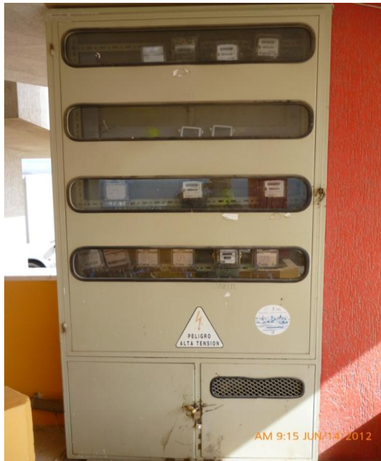
Figura 1.6 Tablero de medidores.
