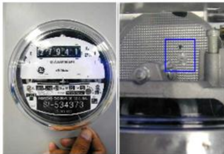
Figura. 1.4 Frenado forzado del disco o rotor del medidor de energía eléctrica.
