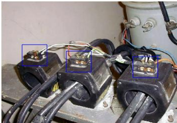
Figura. 1.5 Intervenciones de las señales de corriente.
