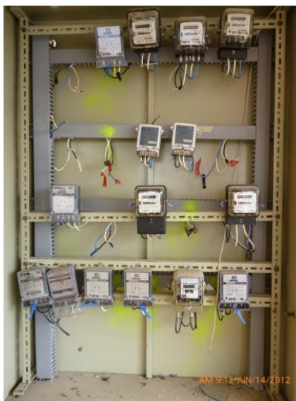
Figura 1.8 Gabinete de Medidores
