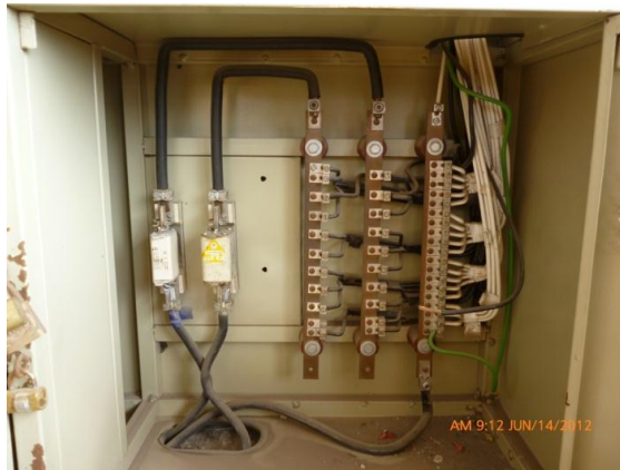
Figura 1.7 Gabinete de Barras
