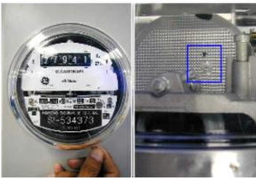
Figura. 1 Frenado forzado del disco o rotor del medidor de energía eléctrica.
