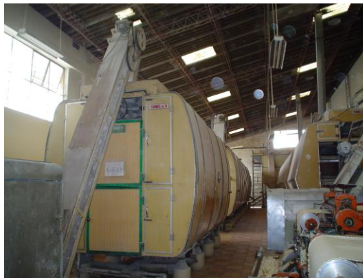
Figura No. 3.5 SISTEMA TÚNELES DE SECADO
