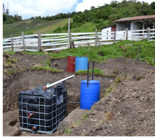
Figura 3.7. Fotografía del sistema anaerobio instalado en la Finca “Rancho Santa Esther”. Mayo 2012. Elaborado por: (Autor).
