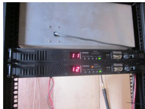
Figura 9: Colocación de repetidores troncalizados [A]
