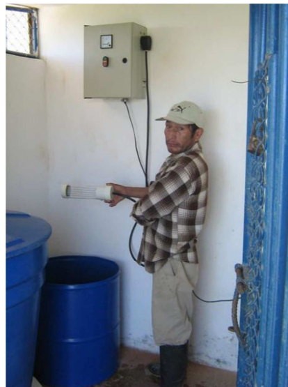
Figura 10. Sistema generador de hipoclorito de sodio
