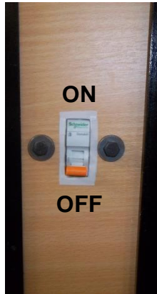
Figura 5.3: Breaker del motor en la posición OFF
