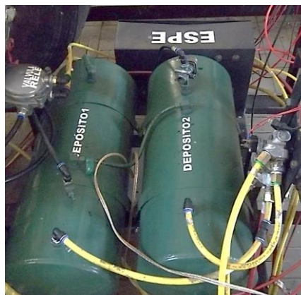
Figura 2.7: Tanque de almacenamiento de aire
