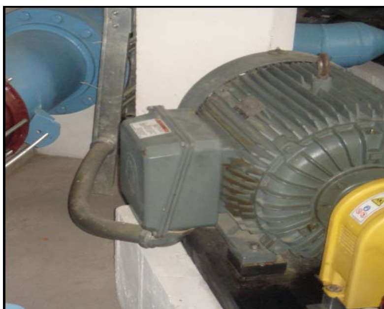
Figura 5.7. Conexión del Motor Eléctrico.
