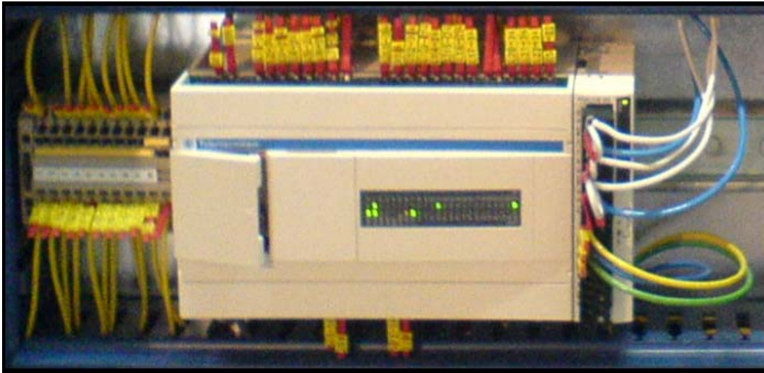
Figura 5.12. PLC Módulo de recepción de las señales análogas.
