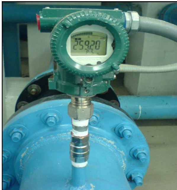
Figura 5.11. Medidor de Presión.
