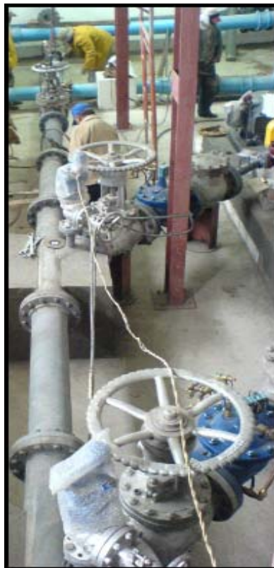
Figura 1.3. Válvulas de compuerta de los grupos de bombeo.
