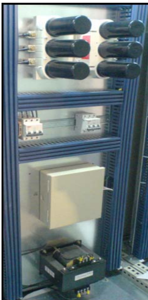
Figura 5.5. Banco de Capacitores y Transformador de 5 KVA.
