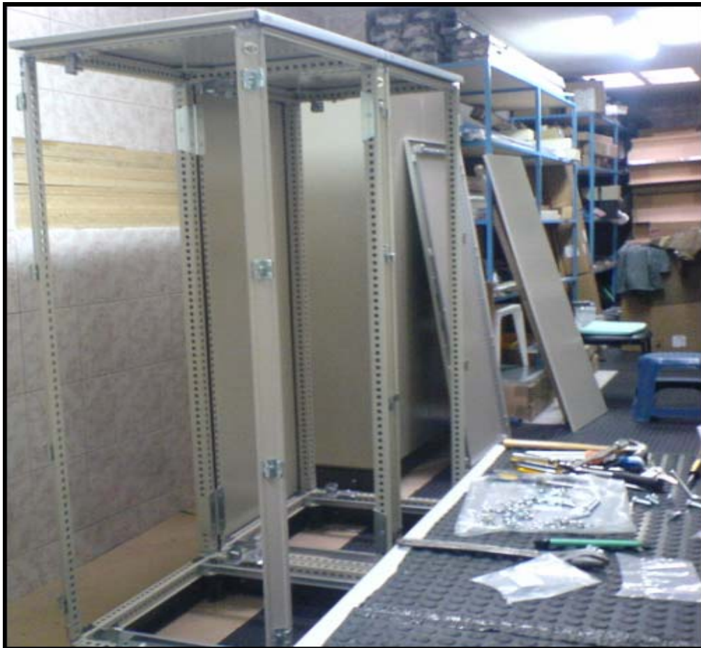
Figura 5.3. Representación de Armado del Gabinete Eléctrico.
