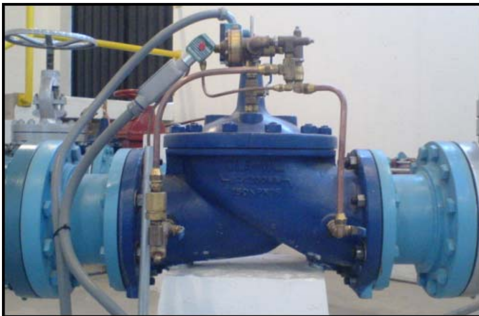
Figura 3.12. Electro-Válvula del sistema de bombeo.
