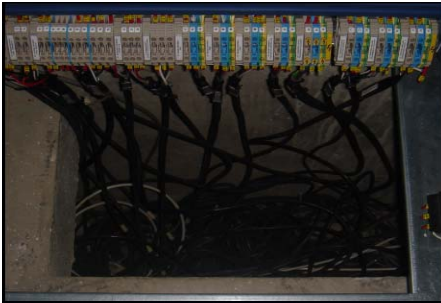
Figura 5.18. Borneras de llegada de los Elementos de instrumentación.
