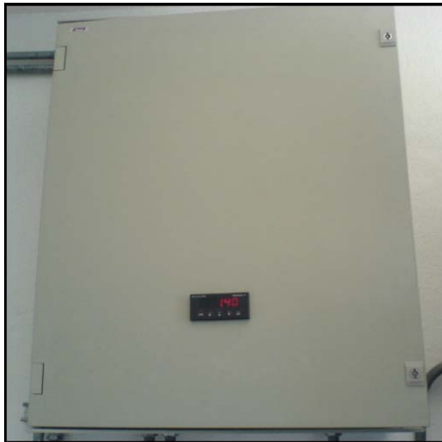
Figura 5.21. Tablero de Comunicaciones del Tanque de Distribución.
