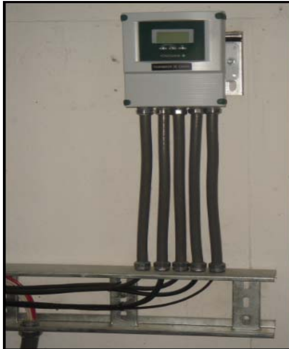
Figura 5.10. Medidor de Caudal.
