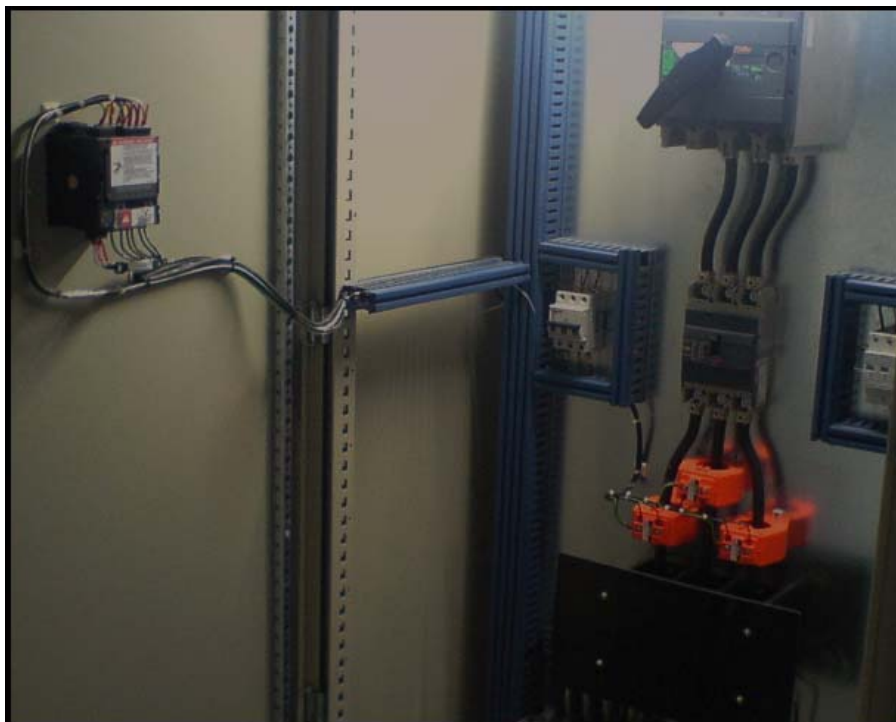
Figura 5.15. Cableado del Medidor de Energía.
