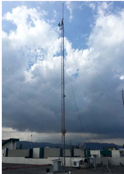
Figura. 2.23. Torre autosoportada ubicada en las instalaciones de la Espe
