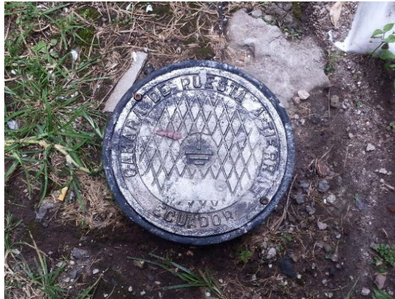
Figura. 4.38. Cámara de puesta a tierra de la Comandancia
