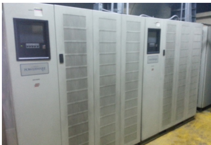
Figura. 4.37. Cuarto de Ups y Generadores Eléctricos en las instalaciones de la Comandancia
