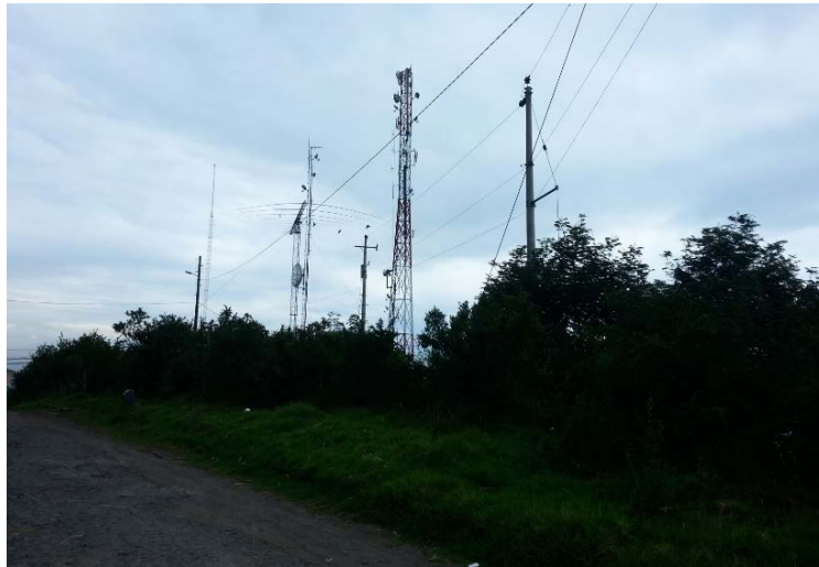
Figura. 2.19. Repetidor de Miravalle
