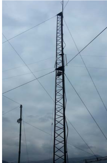
Figura. 3.34. Torre de telecomunicación ubicada en la Comandancia General del Ejército
