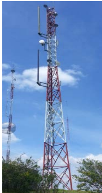
Figura. 3.35. Torre de telecomunicación ubicada en Miravalle
