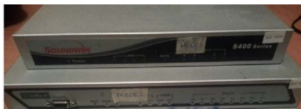
Figura. 2.5. GATEWAY DE VOZ - TK 1008/4FXS-4FXO ubicado en las instalaciones del departamento de la UITICS de la ESPE
