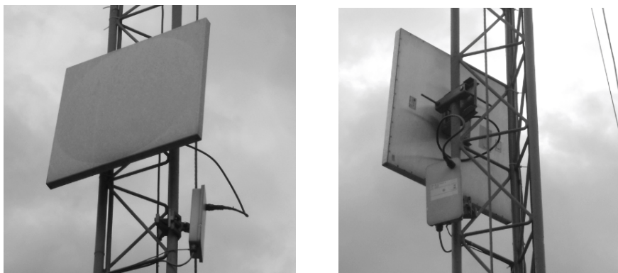
Figura. 2.3. AIRMUX-200/ODU/5.4HP/EXT ubicado en el mástil de las instalaciones de la terraza del edificio central de la Escuela Politécnica del Ejército
