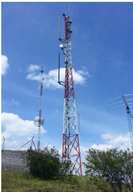
Figura. 2.21. Torre de telecomunicaciones ubicada en Miravalle
