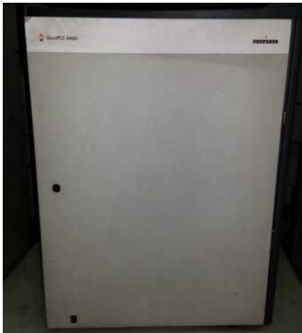
Figura. 3.9. Central ALCATEL OmniPCX 4400
