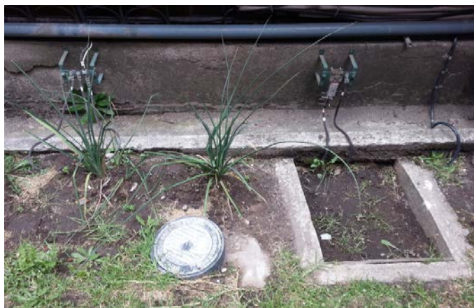
Figura. 4.39. Sistema de puesta a tierra de la Comandancia
