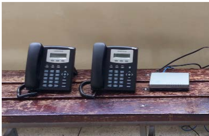
Figura. 5.37. Teléfonos Grandstream conectados a un switch para acceder al sistema Mode
