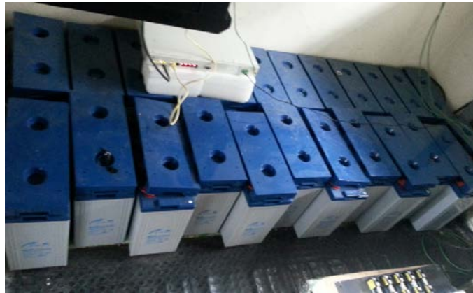
Figura. 4.31. Sistema de respaldo eléctrico en Miravalle
