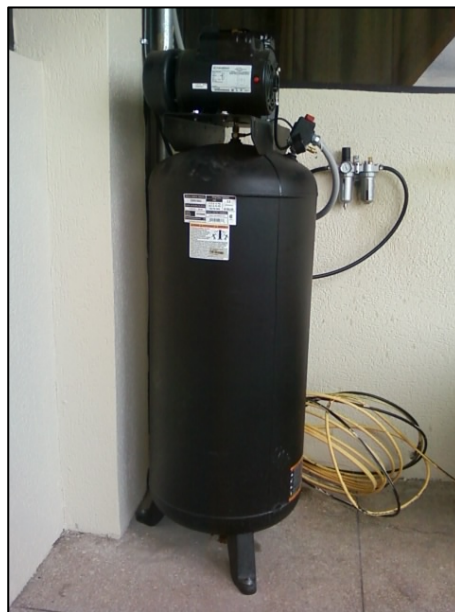
Fig. 3.78 Compresor laboratorio de robótica industrial.
