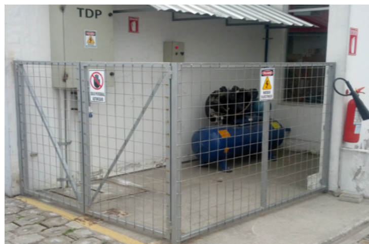
Fig. 4.5 Cerca del Compresor Instalada.
