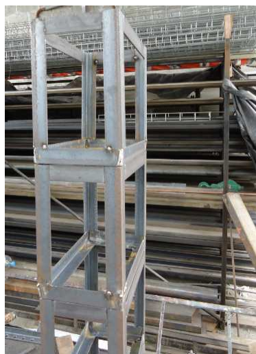
Figura 4.18. Cajones soportes de baterías
