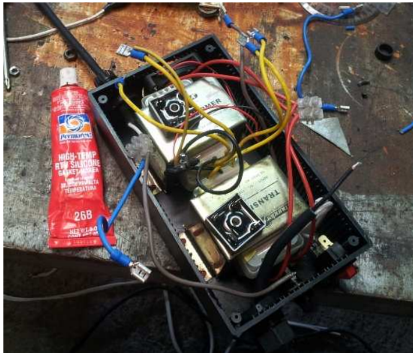
Figura 4.29. Caja del cargador de baterías
