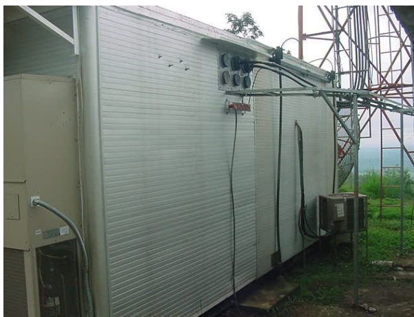
Figura. 3.46. Una estación base transportable de acero vista de dos lados distintos.
