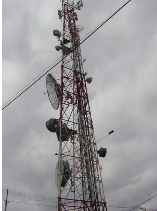
Figura. 3.36. Algunas torres son diseñadas para cargas de platos de alta densidad. Nótese que algunos de estos tienen una cobertura para protección climática.
