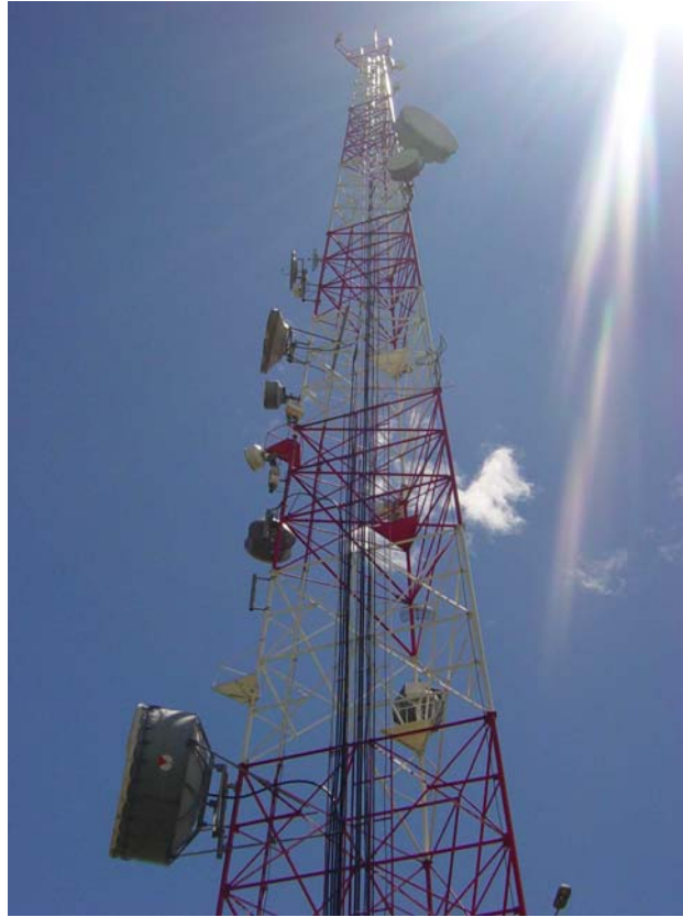
Figura. 3.31. Una torre celular/microondas con una plataforma de 3.5 * 3.5 Metros Cuadrados para antenas celulares.
