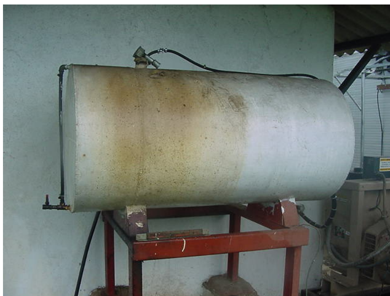
Figura. 3.13. Tanque de combustible para el generador.
