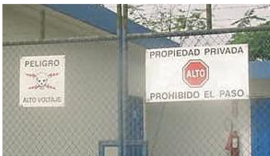
Figura. 3.39. Señales de precaución.
