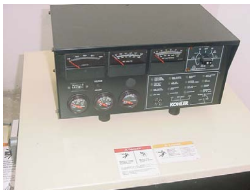
Figura. 3.12. Dos generadores de diferentes fabricantes y tablero de control de uno ellos.
