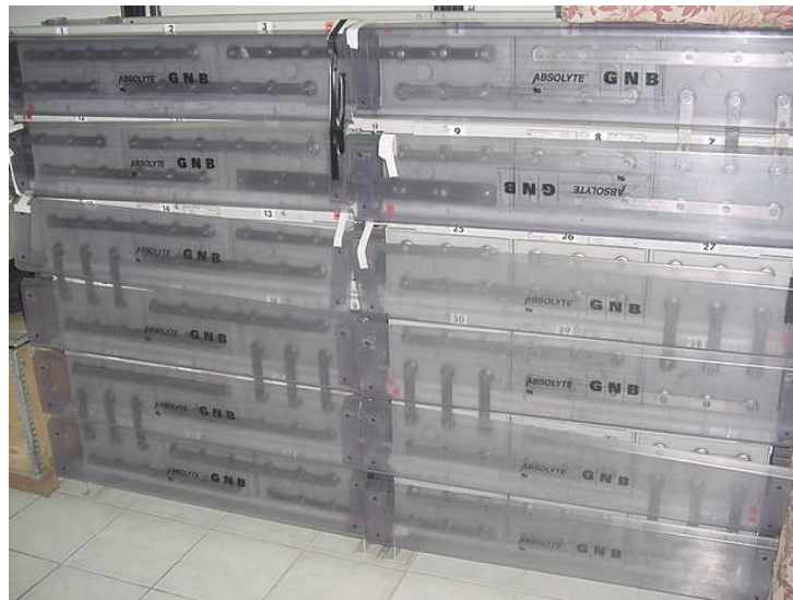
Figura. 3.11. Bancos de Baterías conectados en serie.
