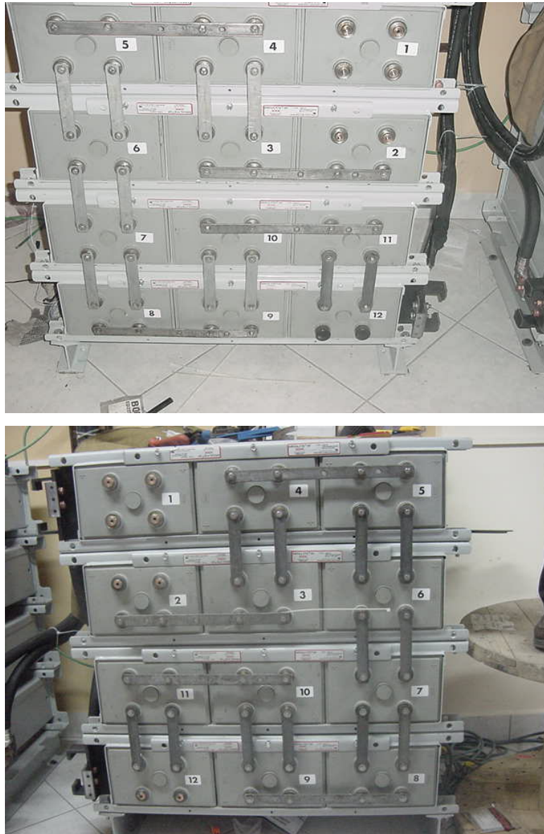
Figura. 3.10. Bancos de Baterías.
