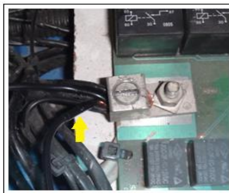
Figura 3.18 Conexión del cable de alimentación del PLC con el punto de voltaje de 24V.
