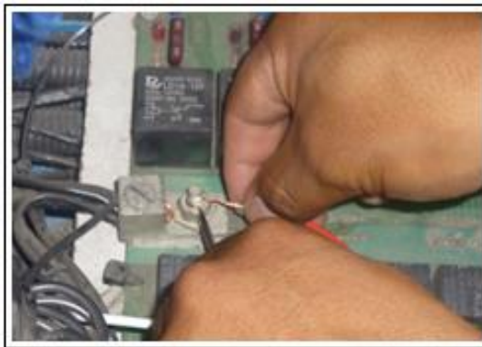
Figura 3.31 Conexión de alimentación del indicador de peligro.
