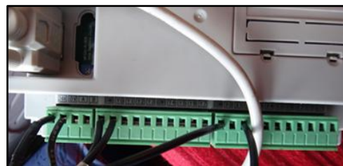
Figura 10. Conexión de entradas y salidas al PLC
