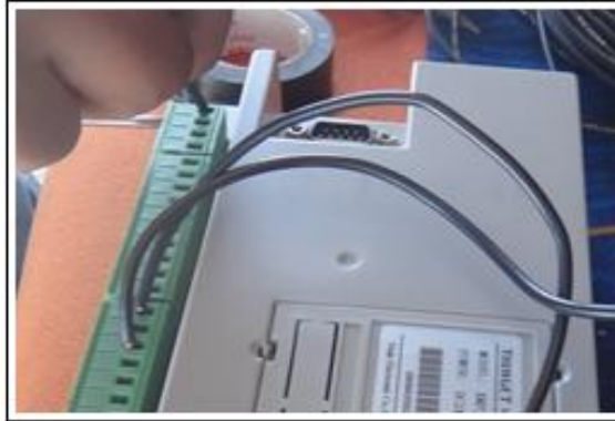
Figura 3.32 Conexión del cable negativo del indicador de peligro al PLC
