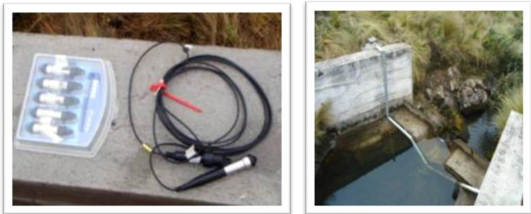
Figura 91. Sensores de nivel instalados en los vertederos
